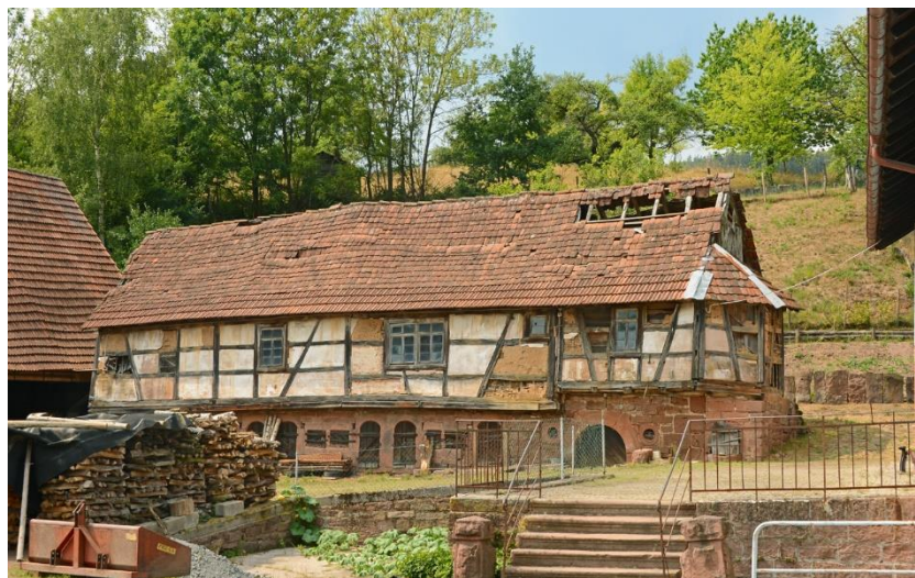
Abb. 10: Der Hubenhof in Sensbachtal, Hauptstraße 37-39, in seinem Zerstörungsstadium von August 2018
